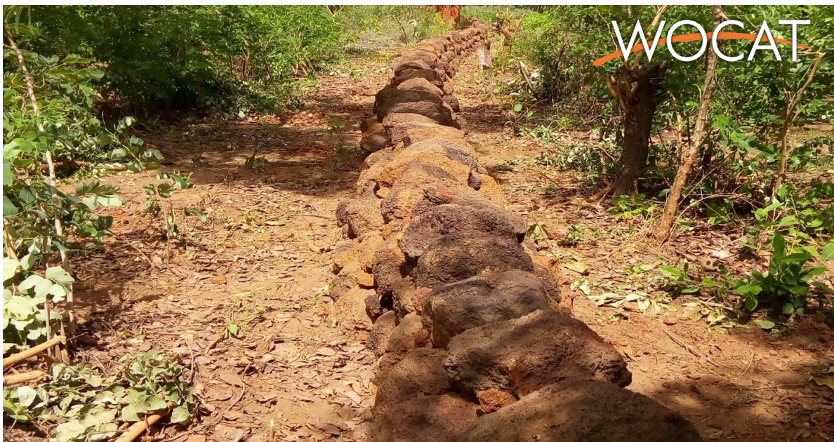
Il s'agit de diguette cinq (05) pierre communément appelé diguette de Tiarako. Cette photographie a été prise dans le village de Tiarako, commune de Satiri (SOME I. Justine)
